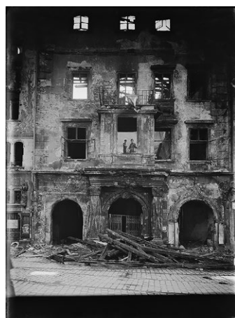
15. House at the Stone Lamb Address: Staroměstské náměstí 551/17, Praha 1 GPS: 50.0871519N, 14.4219000E
